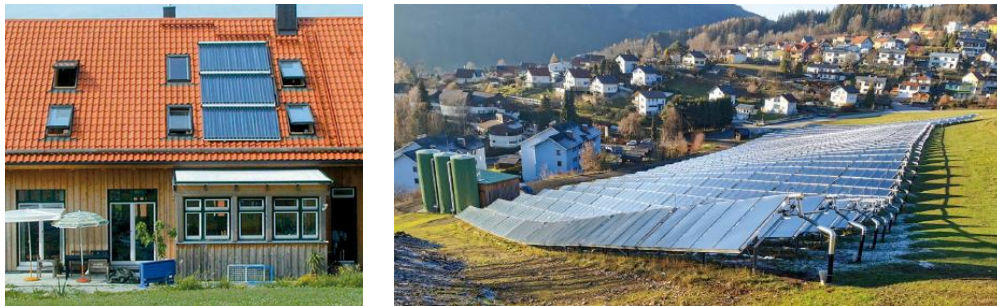
Figura 4. Ejemplos de instalaciones de energía solar de baja temperatura para uso individual (izquierda): Vivienda unifamiliar con colectores de tubos de vacío en Alemania. Y para uso colectivo (Derecha): Sistema de calefacción solar de distrito en Müzzuschlag, Austria (Fuente IEA, [3] )
