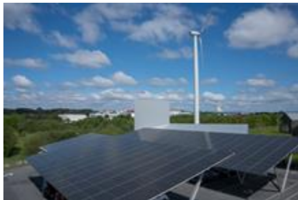
Aerogenerador Norvento NED100 para Autoconsumo aislado (Fuente: Norvento Enerxia)
