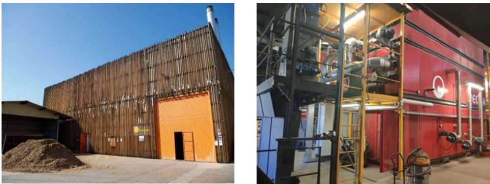
Figura 3 LA RED DE MÓSTOLES ECONENERGÍA para calefacción y agua caliente sanitaria
